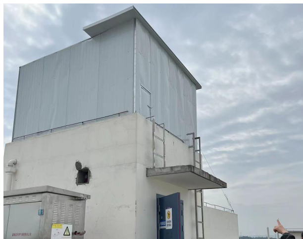
饮食油烟专用管道排放口
