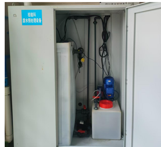
检验废水预处理设备
