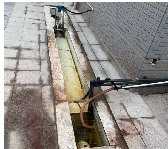
污水处理站排口
