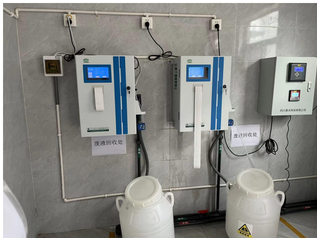
污水处理站在线设备
